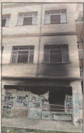
I danni all'esterno della scuola
