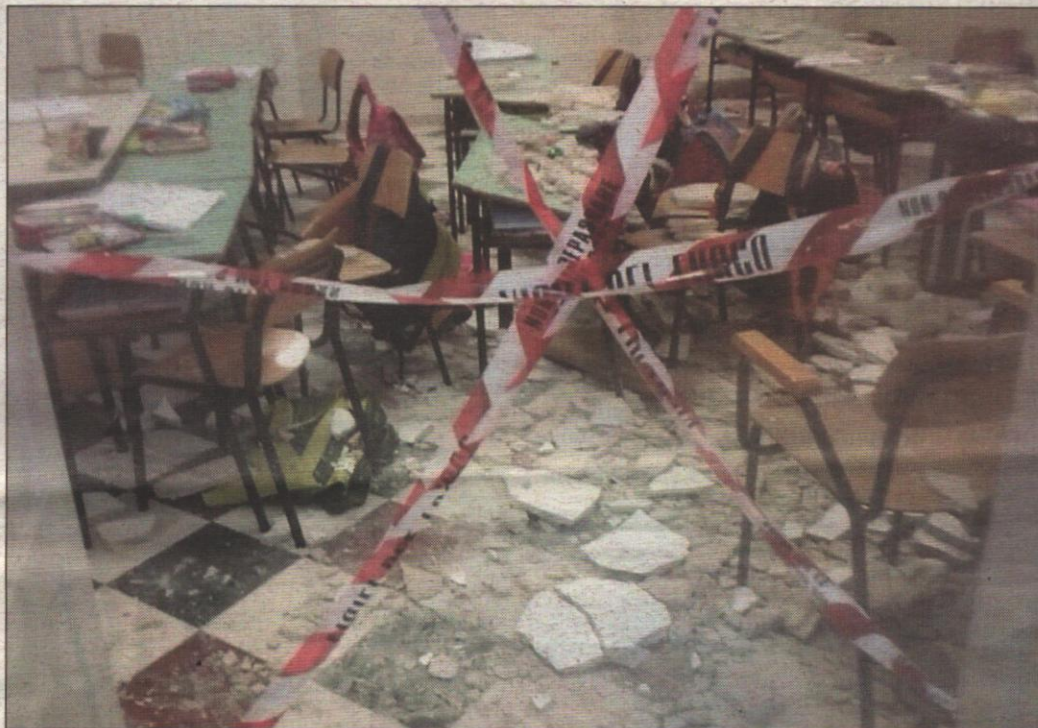
L'aula sgombra dopo il cedimento del soffitto: calcinacci e tufo sui banchi, sui quaderni e sui libri dei bambini
