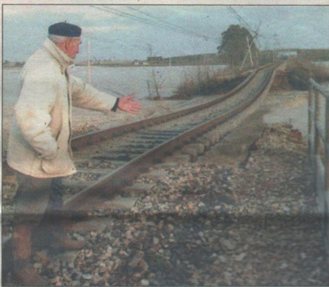
Il tratto della linea ferroviaria, nei pressi di Ripalta, danneggiato e poi ripristinato
